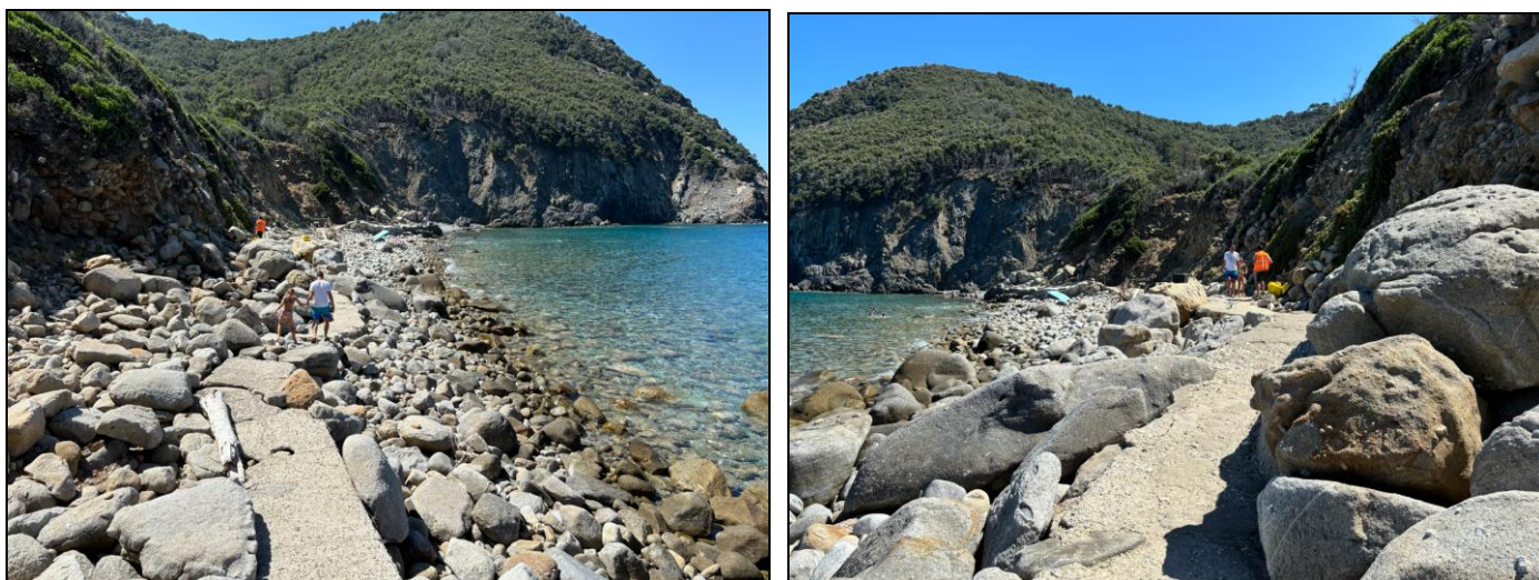
Figura 4-2 - Dettagli del camminamento in calcestruzzo che attraversa l'arenile di Patresi. Si notino i localizzati danneggiamenti dello stesso, causati in gran parte dalla caduta di materiale lapideo dal versante sovrastante.
