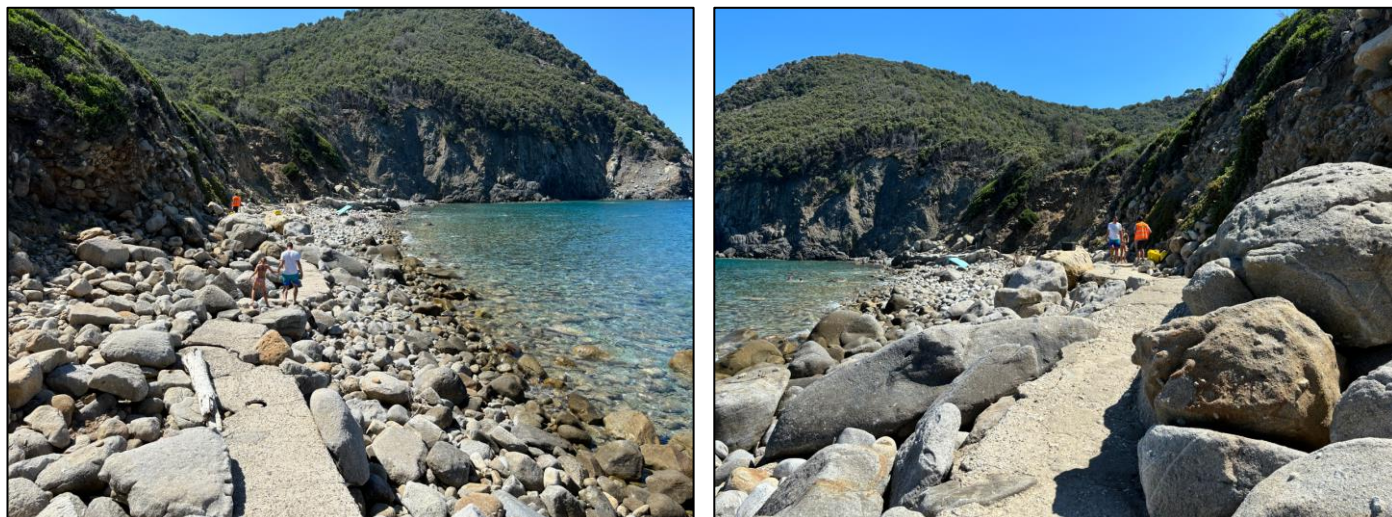
Figura 5-2 - Dettagli del camminamento in calcestruzzo che attraversa l'arenile di patresi. Si notino i localizzati danneggiamenti dello stesso, causati in gran parte della caduta di materiale lapideo dal versante sovrastante.
