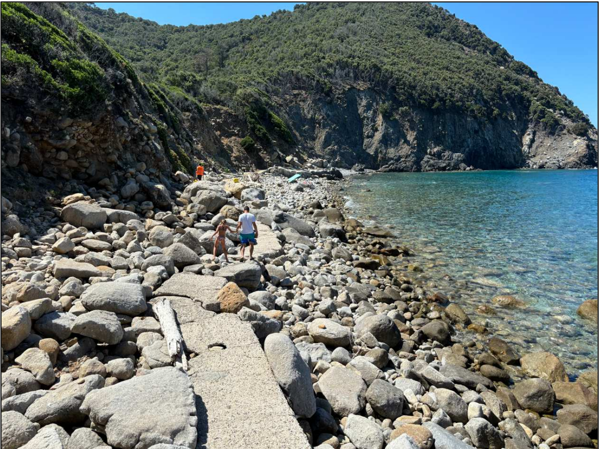
Figura 3.3 Dettagli del camminamento in calcestruzzo che attraversa l'arenile di patresi. Si notino i localizzati danneggiamenti dello stesso, causati in gran parte della caduta di materiale lapideo dal versante sovrastante
