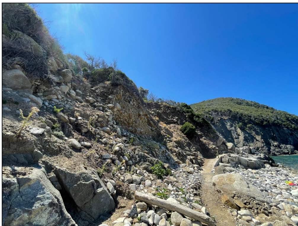
Figura 5-2 - Vista del versante sovrastante l'arenile di Patresi, con i numerosi massi instabili a rischio crollo.
