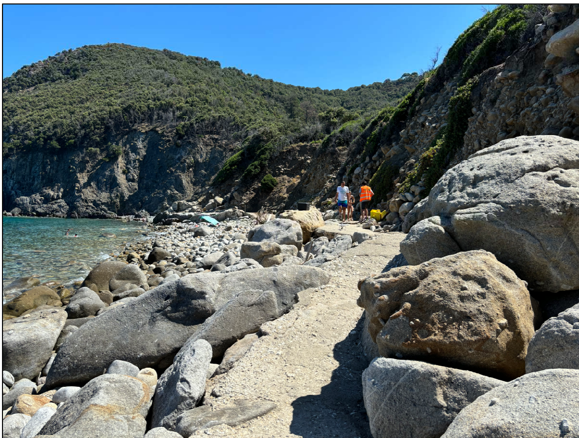
Figura 3.4 Dettagli del camminamento in calcestruzzo che attraversa l'arenile di Patresi. Si notino i localizzati danneggiamenti dello stesso, causati in gran parte della caduta di materiale lapideo dal versante sovrastante.
